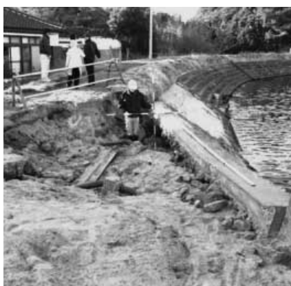
護岸が崩れた関根川河口
