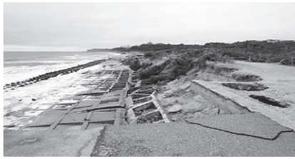
赤浜海岸 堤防崩落箇所
