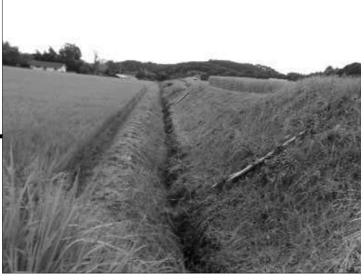
水路の吸出しに伴い法面陥没等、維持管理に苦慮。
