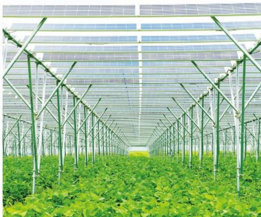
©市民エネルギーちば(株) 匝瑳市 メガソーラー発電所
