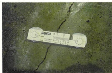
クラックゲージ設置状況
