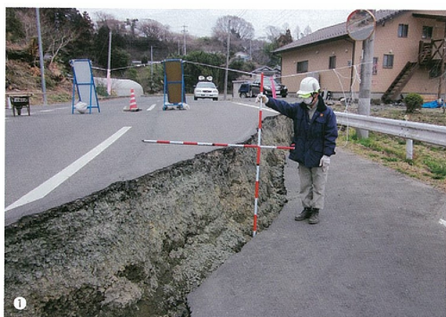
■ 1m以上の段差ができた市道 208 号線
