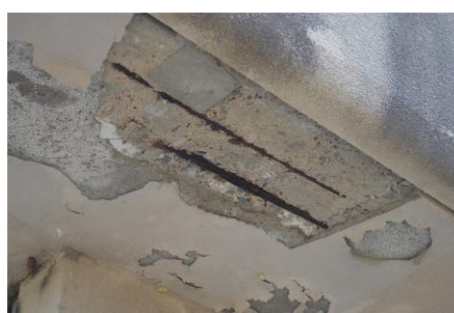
コンクリートの剥落
