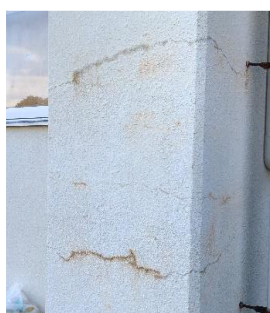
錆汁を伴うひび割れ
