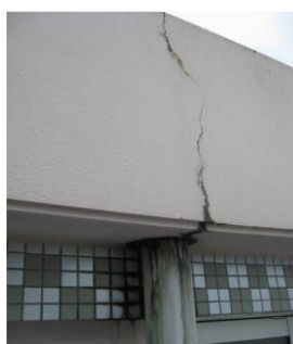
構造躯体のひび割れ
