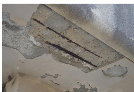
コンクリートの剥落
