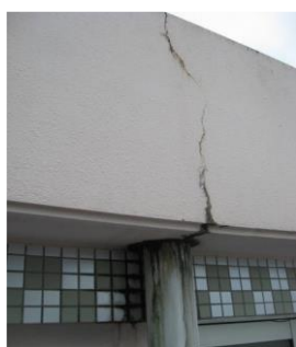
構造躯体のひび割れ
