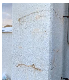
錆汁を伴うひび割れ
