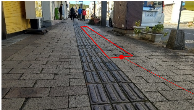
不陸による歩道部の段差
