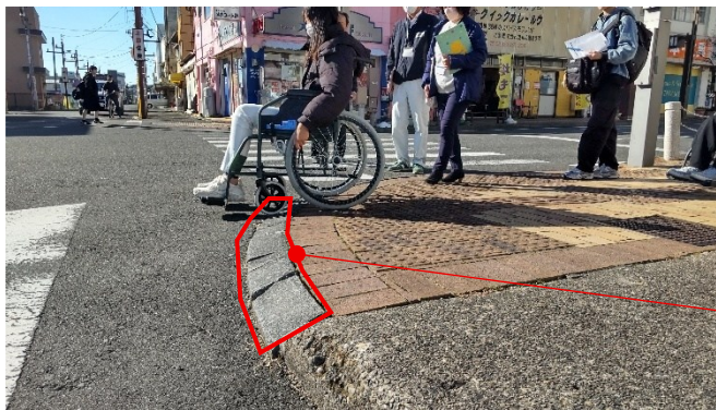
歩道部と車道部の段差
