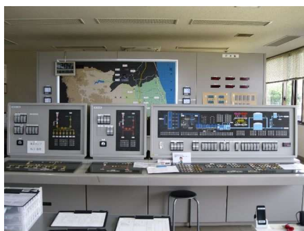
関口浄水場 中央監視装置
