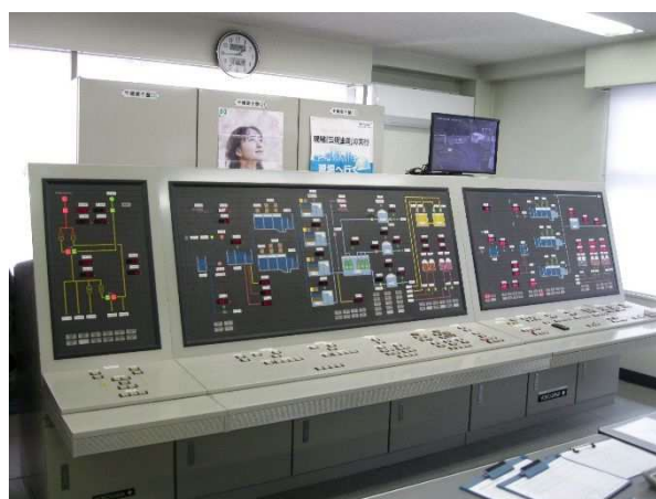
第一浄水場 中央監視装置
