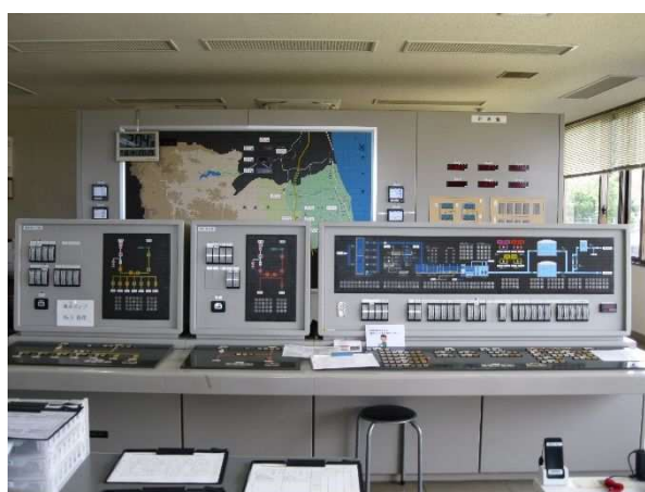
関口浄水場 中央監視装置
