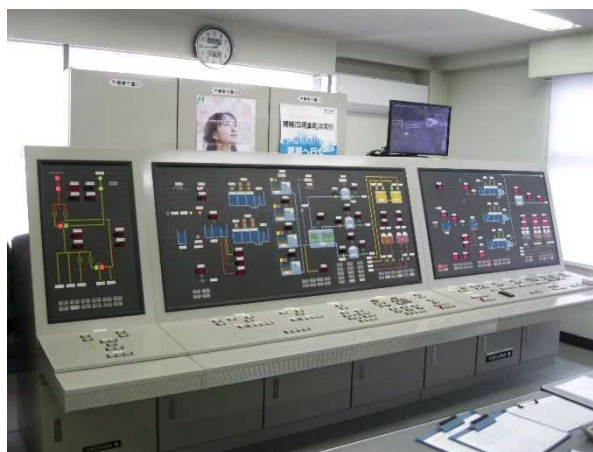
第一浄水場 中央監視装置
