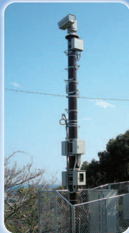
高萩高等学校に設置された 津波監視カメラ
