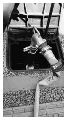
スタンドパイプ
