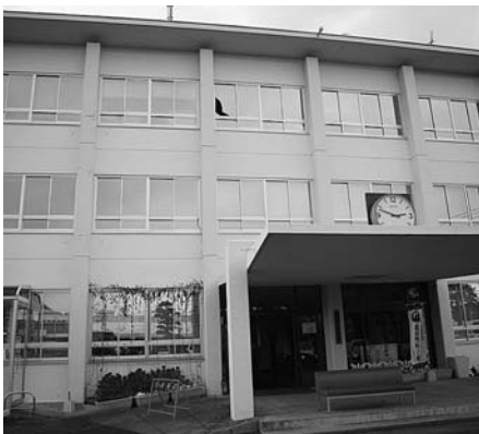
被災した市役所本庁舎
