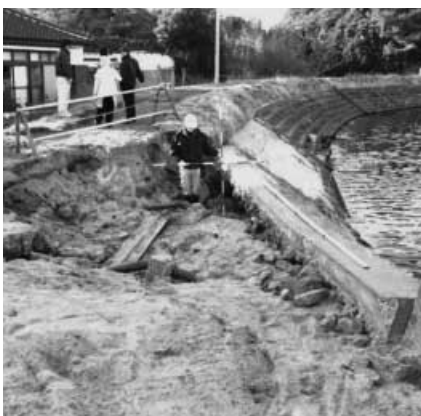
護岸が崩れた関根川河口
